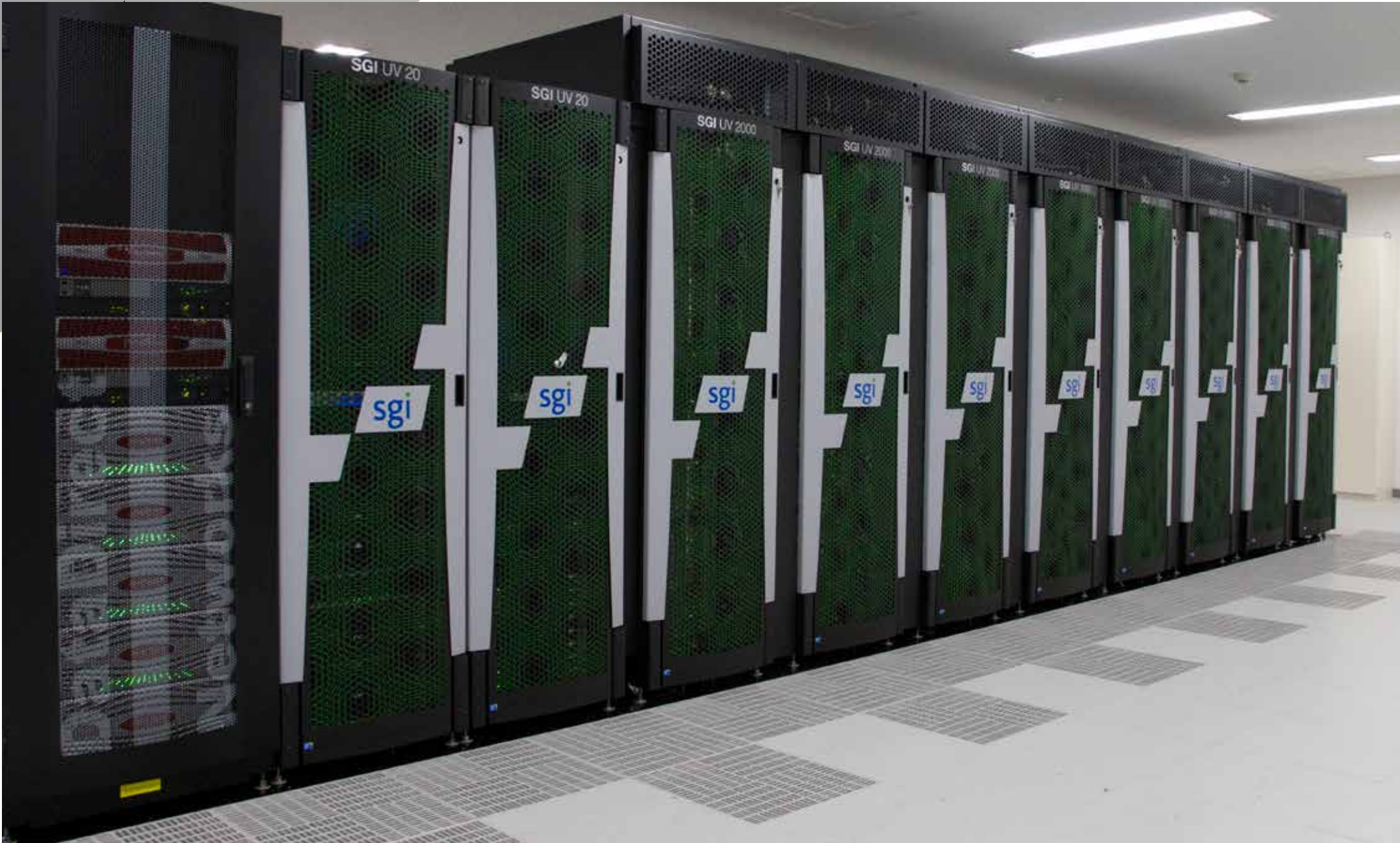
データ同化スーパーコンピュータシステム
